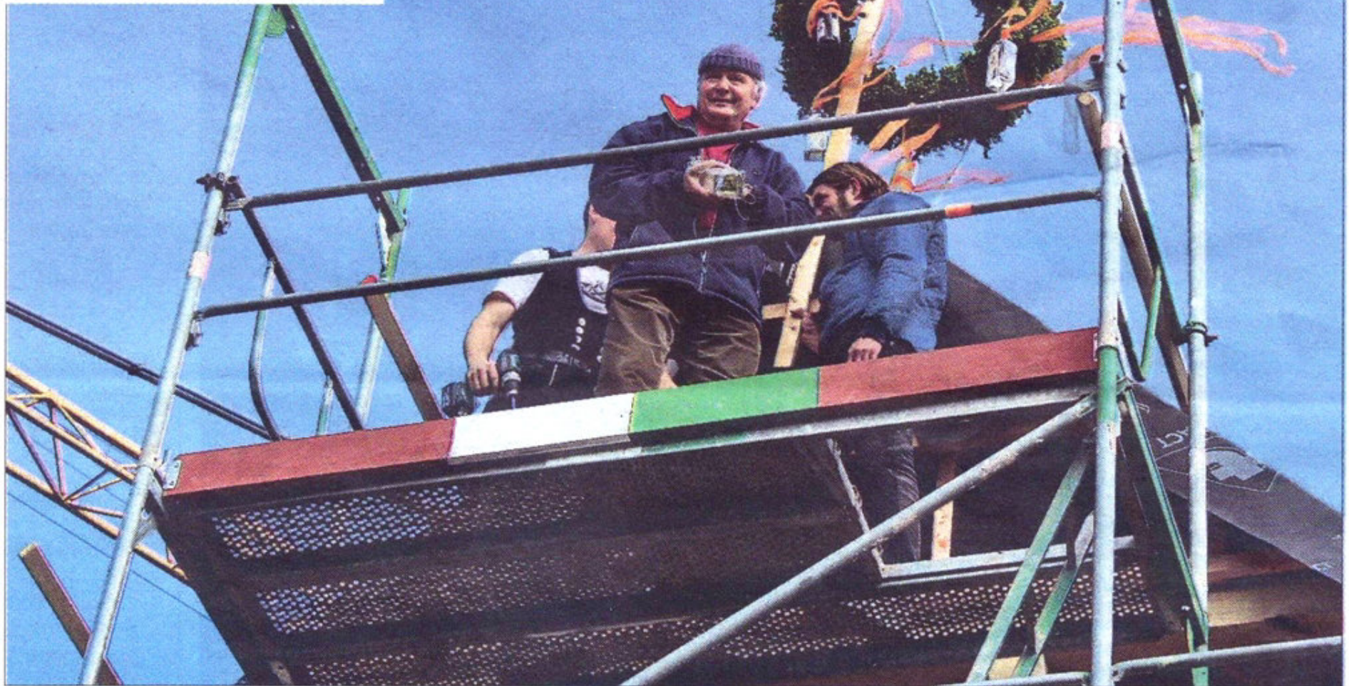
Der Stiftungsvorsitzende Bernd Hildebrandt (großes Bild, Mitte) versorgt die durstigen Handwerker, die den Richtkranz gesetzt haben. Die beiden Fachwerkbauten (kleines Bild) sollen ab dem nächsten Jahr für die Reittherapie und als Unterkunft dienen. Sokoll (2)
